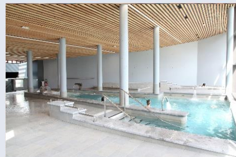
Espace balnéo couvert et chauffé
