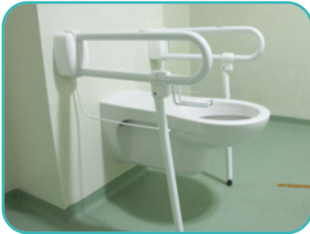
Barres de maintien escamotables avec béquille de renfort de part et d'autre de la cuvette WC
